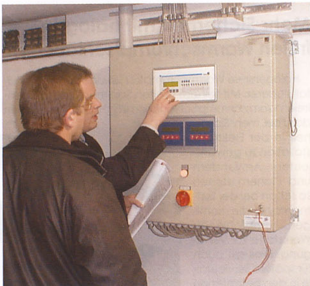
Frischwassertechnologie und Gebäudemanagement sind in einem Schaltschrank untergebracht
